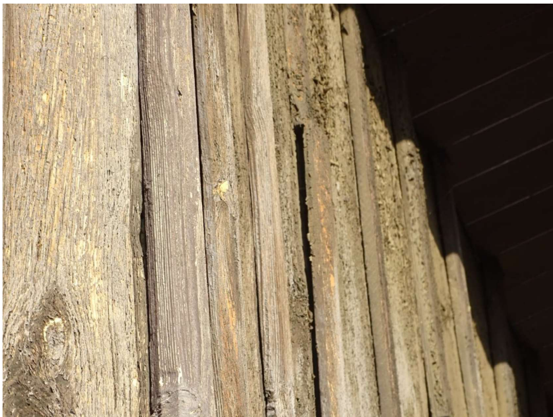
Fot.35 Odspojenia listew szalowania
