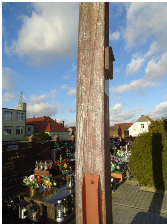
Fot.38 Wypłowiła warstwa ochronna oraz ubytki lakierów
