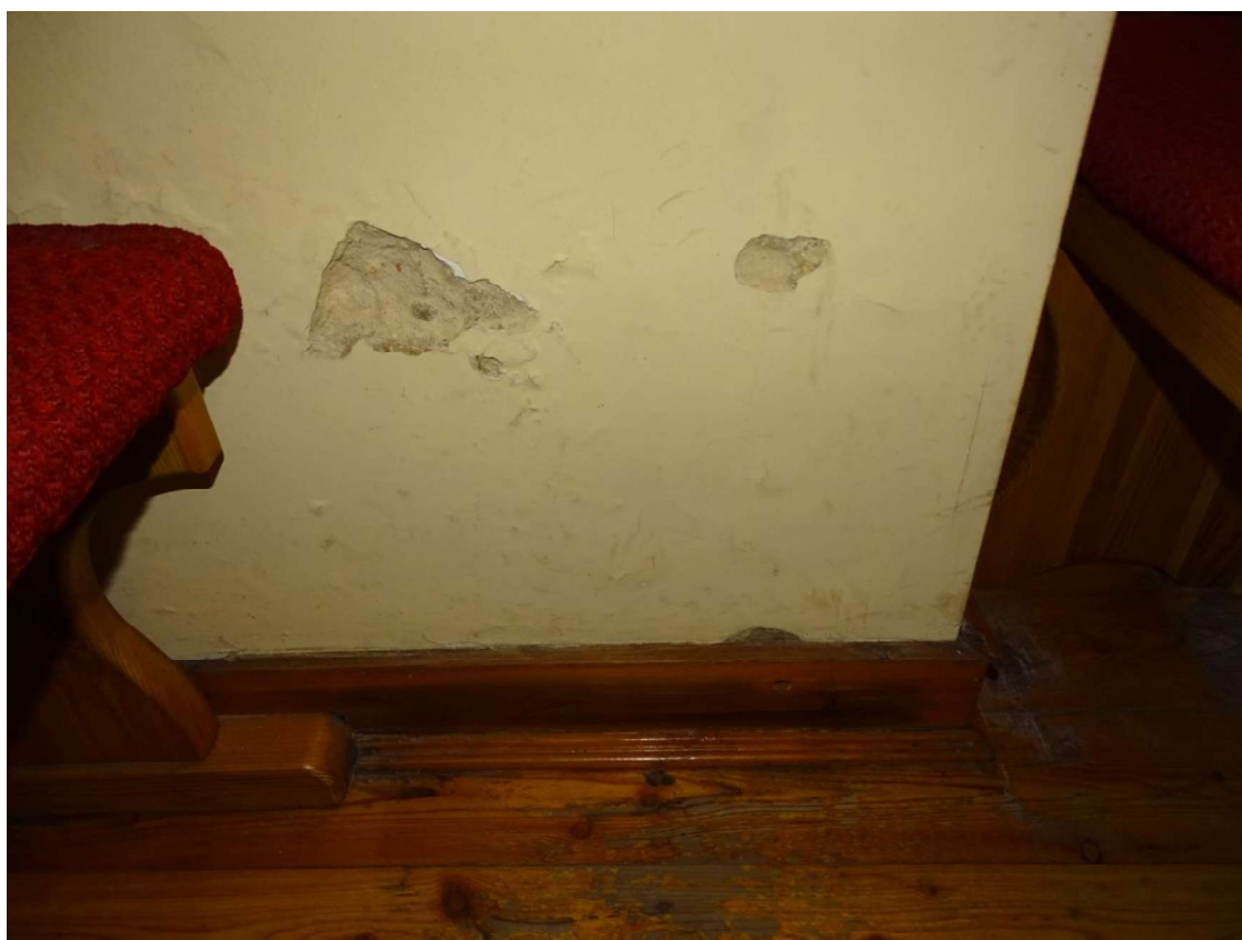
Fot.23 Zasolenia i zawilgocenia ścian
