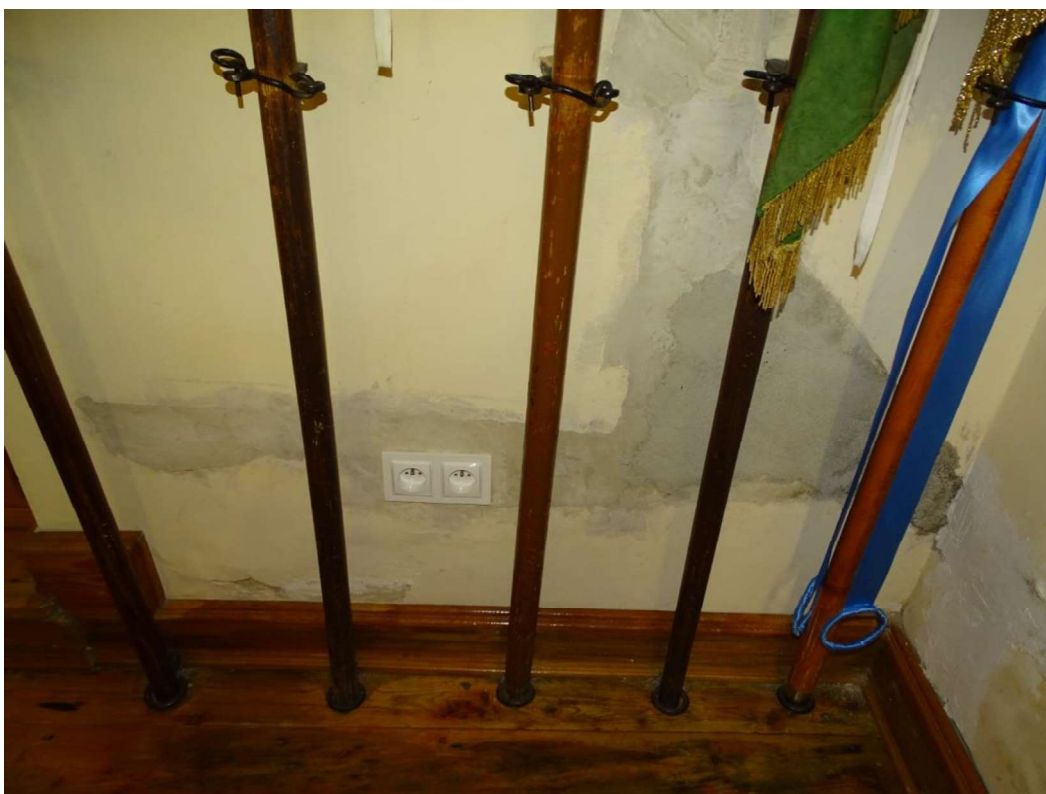
Fot.19 Zły stan techniczny tynków przyziemia
