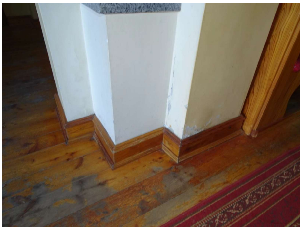
Fot.19 Zły stan techniczny tynków przyziemia
