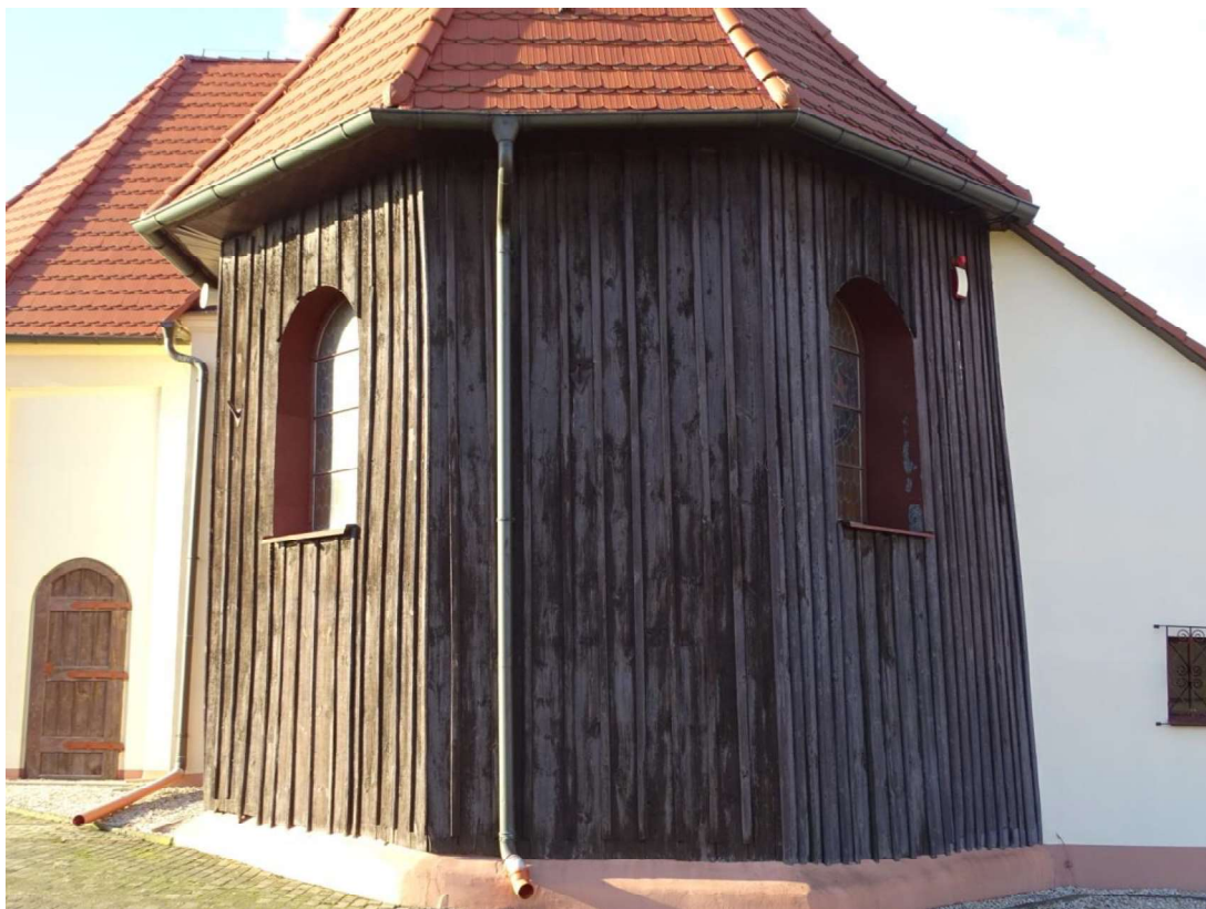
Fot.32 Ubytki i zruszczenia warstwy ochronnej oszalowania ścian zewnętrznych
