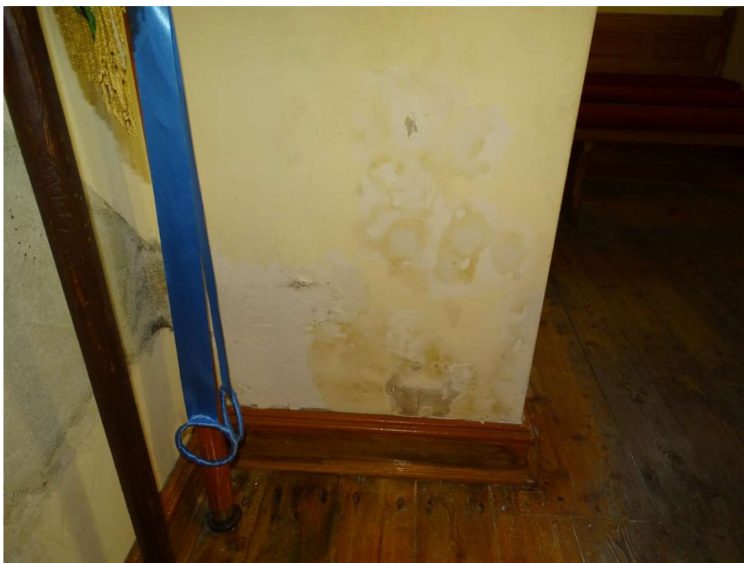
Fot.23 Zasolenia i zawilgocenia ścian
