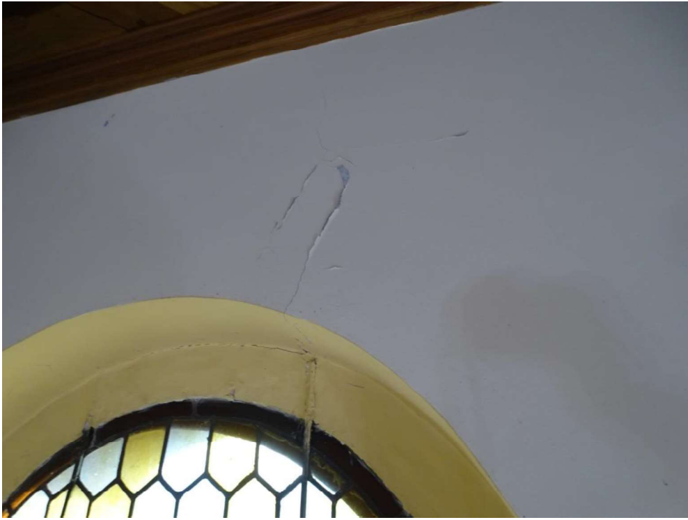
Fot.21 spękania i rozwarstwienia warstw malarskich
