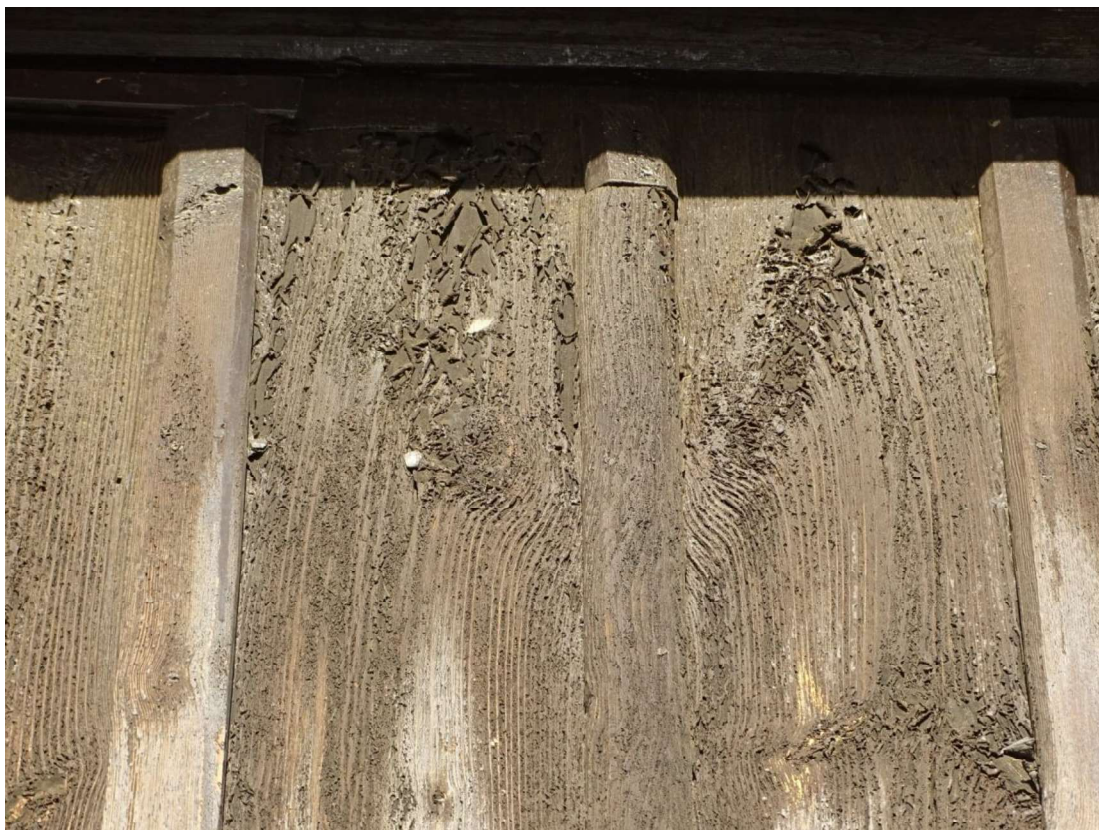
Fot.33 Ubytki i zruszczenia warstwy ochronnej oszalowania ścian zewnętrznych
