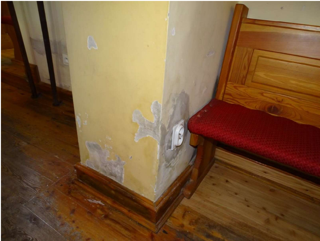
Fot.27 Uszkodzenia mechaniczne ścian
