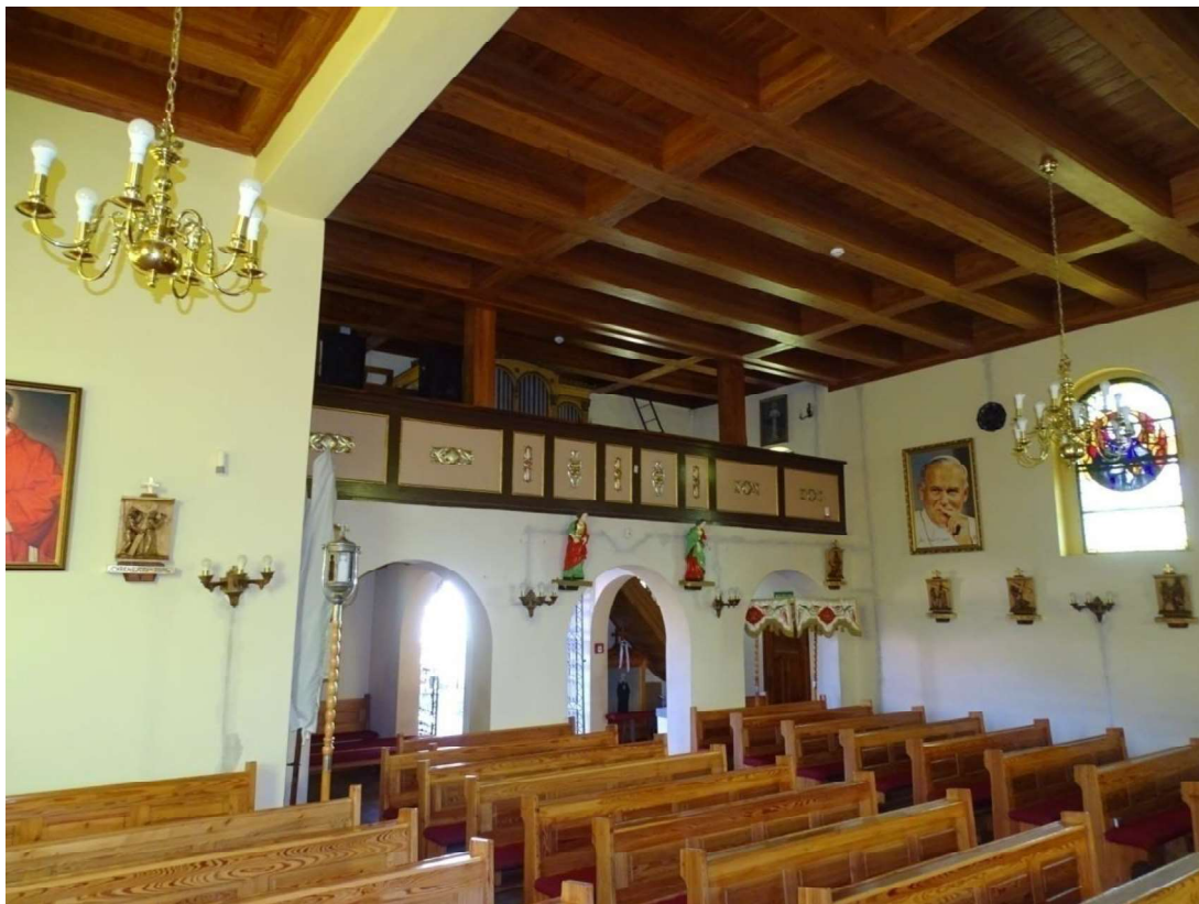
Fot.28 Ściany wymagające rekonstrukcji kolorystycznej
