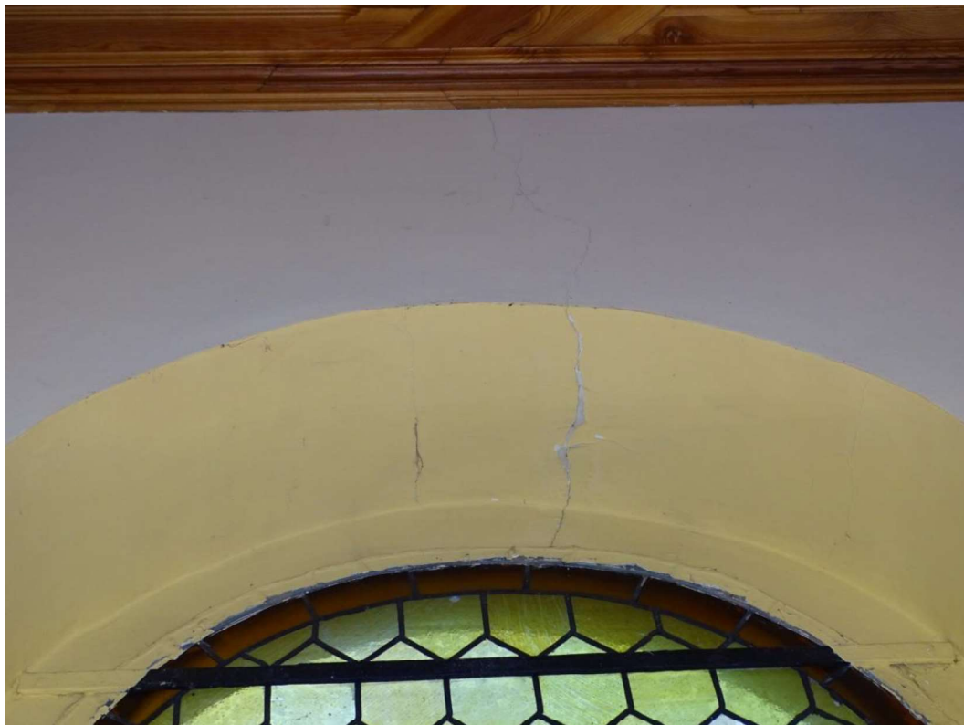
Fot.22 spękania i rozwarstwienia warstw malarskich
