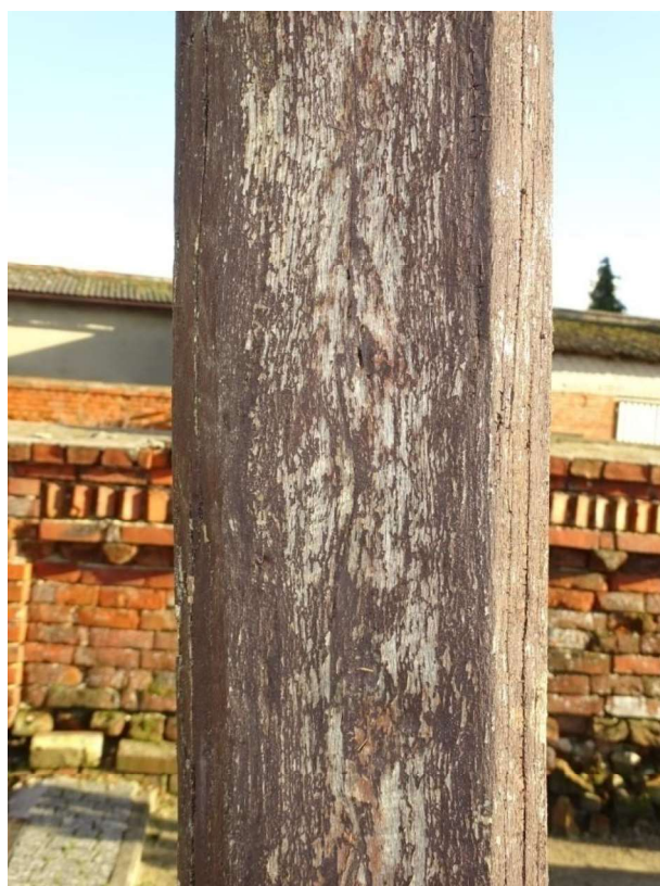
Fot.40 Wypłowiła warstwa ochronna oraz ubytki lakierów
