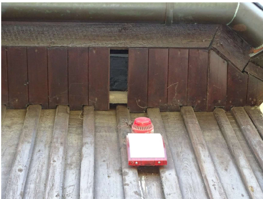
Fot.36 Ubytki deskowania podbitki
