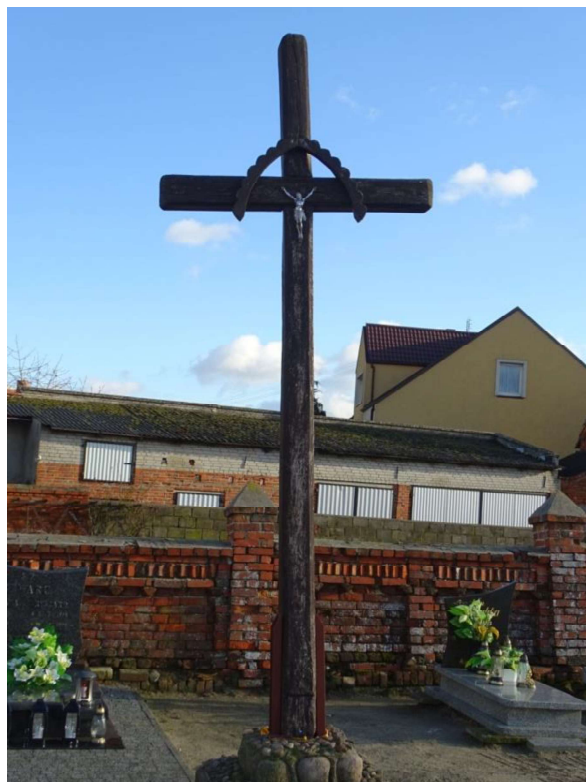
Fot.39 Wypłowiła warstwa ochronna oraz ubytki lakierów
