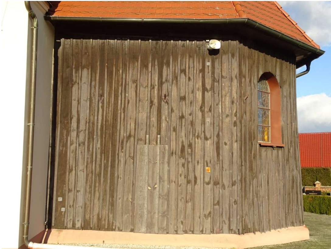
Fot.31 Ubytki i zruszczenia warstwy ochronnej oszalowania ścian zewnętrznych
